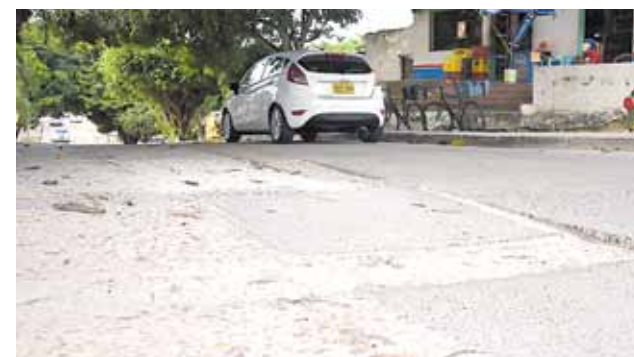
En las inmediaciones de la calle 79 con carrera 41 D del barrio Ciudad Jardín, las plaquetas de concreto están desniveladas.
