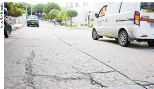
Las zanjas que se han ido presentando en las vías están a la vista de todo el trayecto.
